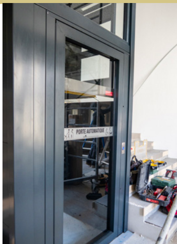
Ci-dessus et ci-contre : L'installation de l'ascenseur dans le hall du cinéma, l'ancien collège Saint-Joseph.
